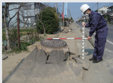
千葉県内で発生した液状化によるマンホールの浮き上がり
