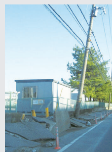
千葉県内で発生した液状化による電柱の傾きと歩道の被害
